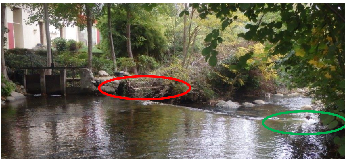
Vue du seuil de la prise d'eau depuis l'amont (bajoyer dégradé dans le cercle rouge, brèche dans le seuil dans le cercle vert)
