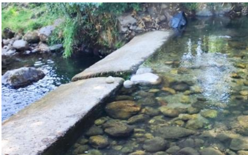
Blocs obstruant l'échancrure du débit réservé.
