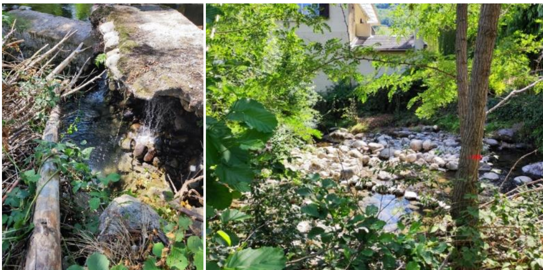
A gauche : Détail du bajoyer dégradé ; à droite : Banc de blocs (dégravoiement bajoyer et apport crue) en aval de la prise d'eau
