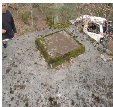
Figure 10 : Réservoir de SOR
