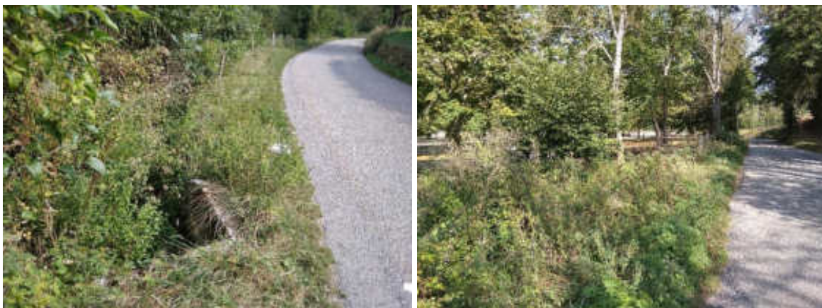
Figure 10 : fossé « perché » encombré entre la sortie de l'ouvrage sous la RD23 et le parking du Parc de la Préhistoire
