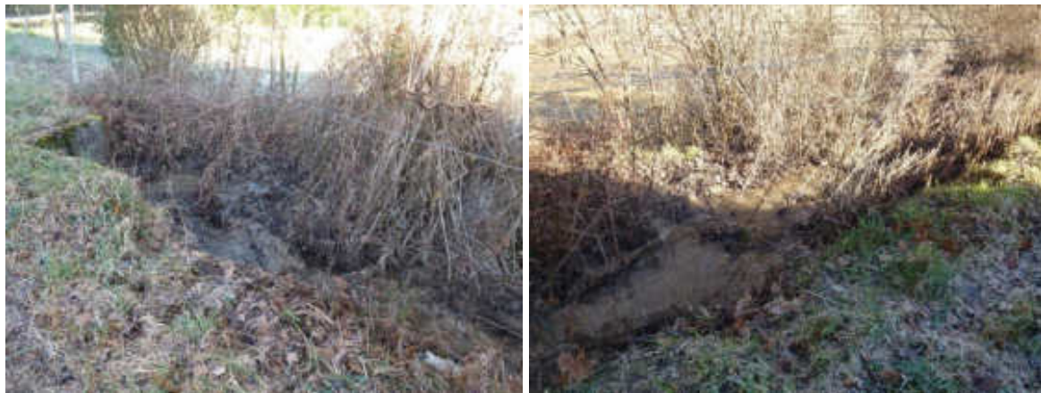
Figure 25 : exhaussement et débordement du fossé en février 2020 à cause du dépôt de fines en sortie de l'ouvrage busé sous la RD23
