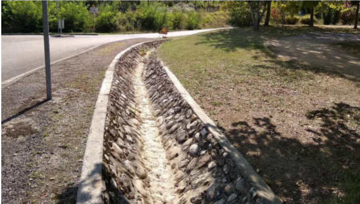
Figure 11 : fossé trapézoïdal maçonné drainant les écoulements résiduels du talweg et les eaux pluviales de la voirie
