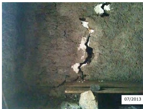
> Témoins en plâtre, glissement de terrain au ravin de Carafa – Source RTM 09
